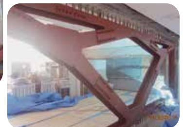
銚子市立第二中学校普通・特別教室棟耐震補強その他改修工事
